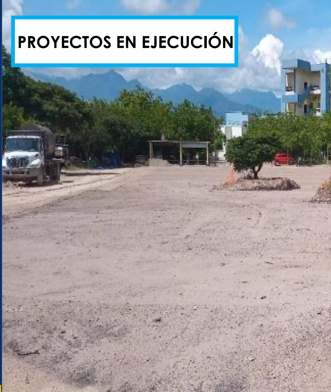
Construcción Primera Etapa de Muro Perimetral y Estacionamiento Adoquinado, UNAH Campus Comayagua
